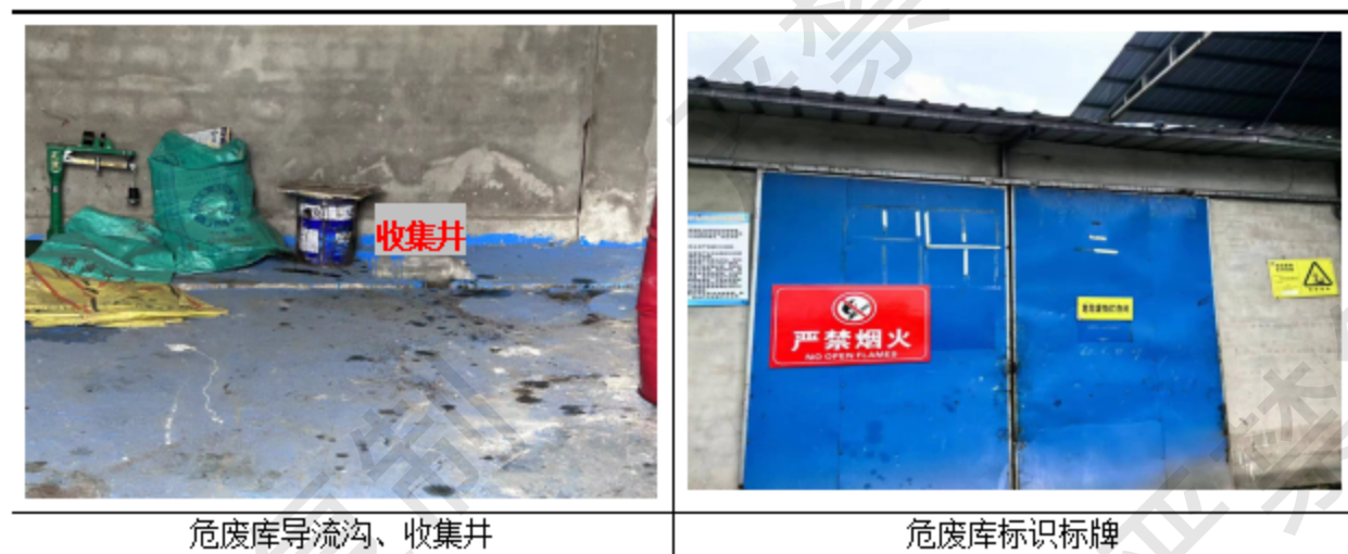
图 2.3-4 现有项目废水环保设施
