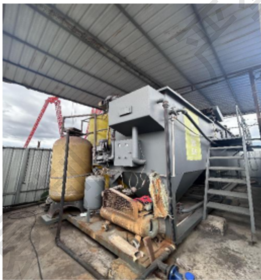
污水处理设施
