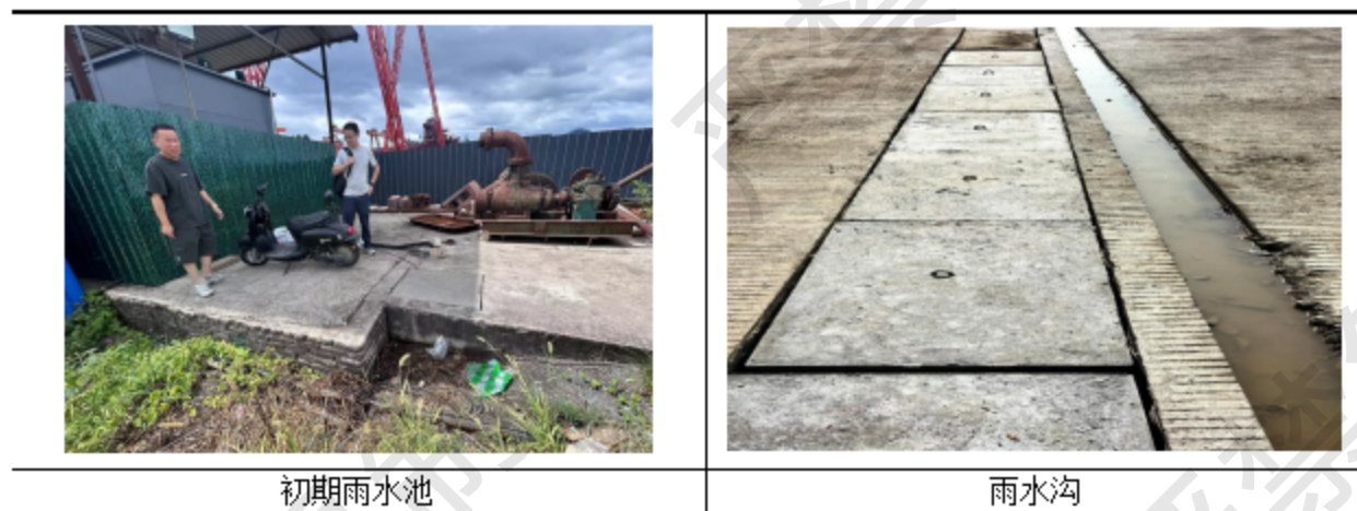
图 2.3-3 现有项目废水环保设施
